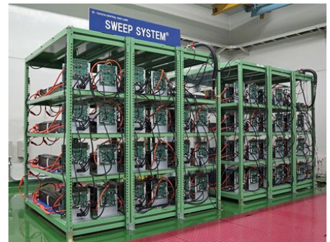
図1 SWEEP SYSTEM®にて制御する、中古電池を繋いだ電力バッファ実験装置
